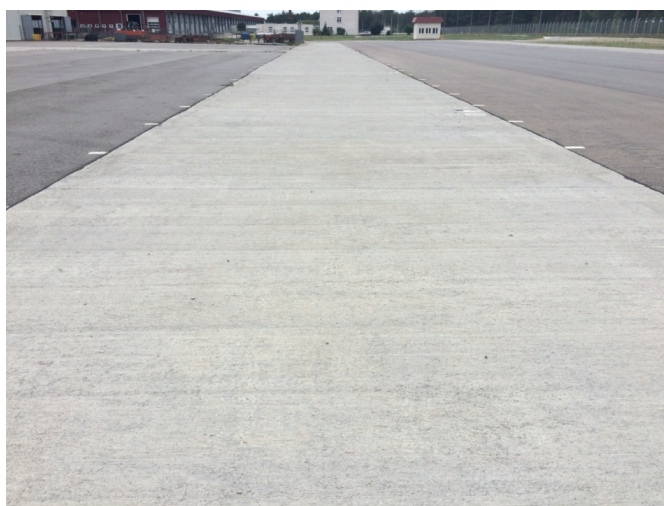
Rys. 4.5. Nawierzchnia drogową z kompozytu cementowego modyfikowanego emulsją bitumiczną po 3 latach eksploatacji. Fot. Autor
