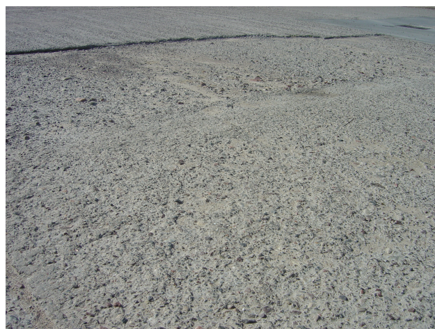
Rys. 1.3. Uszkodzenia w postaci złuszczeń nawierzchni betonowej po 20 latach użytkowania na skutek agresji mrozowej. Zakłady Mięsne „Dolina Łąk” (woj. lubelskie). Fot. Autor
