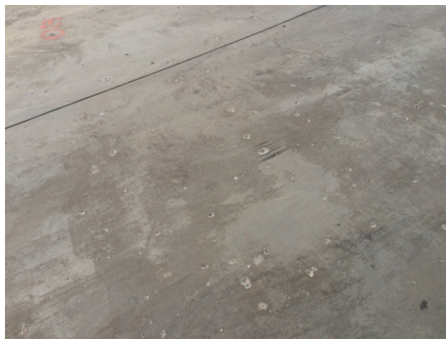
Rys. 1.2. Uszkodzenia w postaci odprysków po 2 latach użytkowania nawierzchni betonowej przy drodze wojewódzkiej nr 868 w Kleosinie k. Białegostoku w wyniku pęcznienia kruszywa. Fot. Autor
