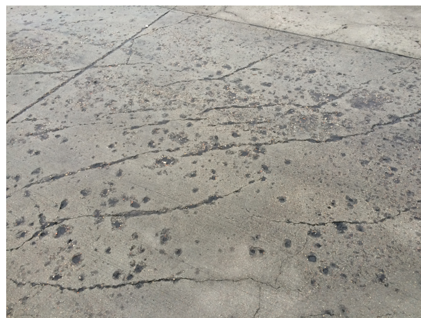
Rys. 1.4. Uszkodzenia nawierzchni betonowej spowodowane skurczem (zarysowanie) i reakcjami alkalicznymi (odpryski) na terenie zakładu produkcyjnego w Sokołowie k. Warszawy. Fot. Autor
