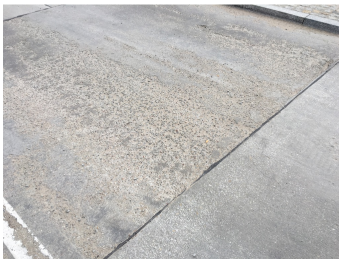
Rys. 1.1. Złuszczenia nawierzchni po 2 latach użytkowania przy Zakładach Mleczarskich „Mlekovita” w Wysokiem Mazowieckiem w wyniku cyklicznego zamrażania i rozmrażania. Fot. Autor
