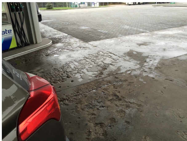
Rys. 1.5. Uszkodzenia nawierzchni betonowej na stacji paliw przy drodze krajowej nr 8 w Zabrodziu w woj. mazowieckim w wyniku ekspozycji na agresywne oddziaływanie środowiska. Fot. Autor
