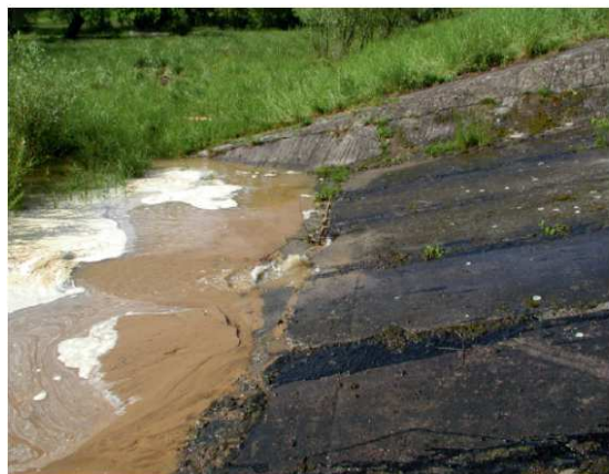
Bild 4: Sandausspülung aus dem Deichüberlaufbauwerk (Suffosion) am rechten Bauwerks- Widerlager
